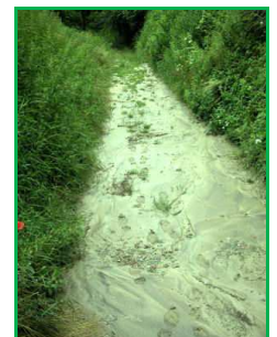
Erosion nach Gewitter 11
